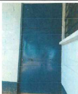
Foto 4: Se observa la necesidad de darle mantenimiento a las puertas del establecimiento educativo
