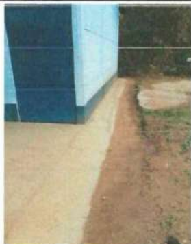
Foto 3: Se observa la necesidad de ampliar los canales de concreto alrededor de toda la escuela
