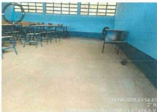
Foto1: Se observa la necesidad de colocar piso cerámico en las instalaciones de la escuela
